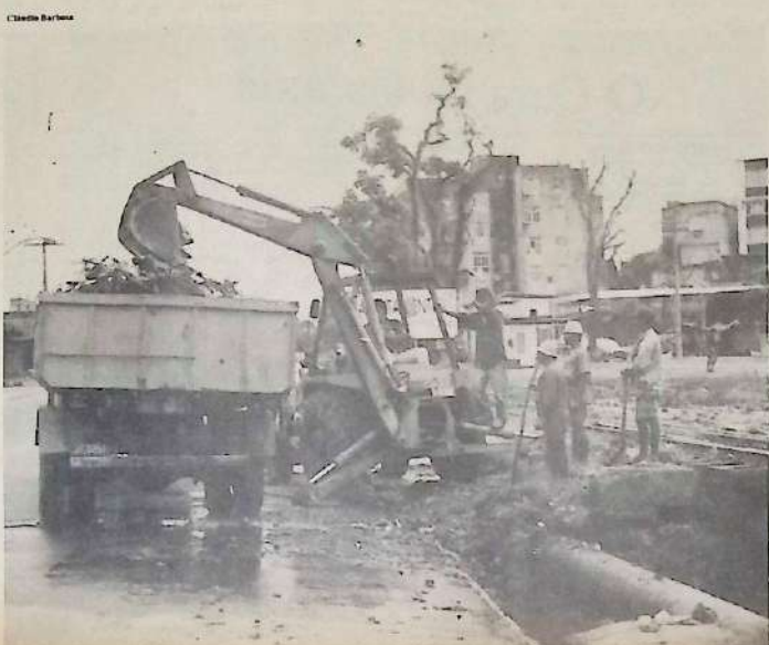
O bairro Vila Lage foi um dos mais atingidos pelas transbordamentos
