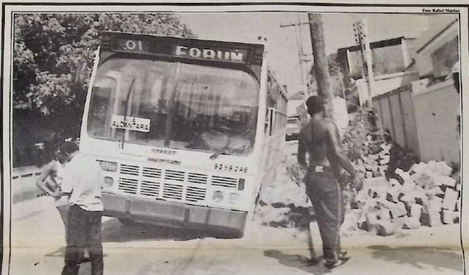
Apesar da garantia da Secretaria de Obras do Estado de que o piso das ruas onde estão sendo colocadas tubulações das obras do Programa de Despoluição da Baía de Guanabara seria reposto tão logo o serviço terminasse, diversas artérias da cidade estão sofrendo com o descumprimento da promessa. Na última sexta-feira, por exemplo, um coletivo da Viação Santa Isabel, que faz a linha até o Fórum, ficou atolado no buraco deixado pelas obras na Rua Cirilo Branco, no Porto da Pedra, e teve que ser retirado por uma retroescavadeira (foto).
