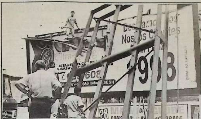
Estruturas perigosas foram desmontadas depois do temporal.
